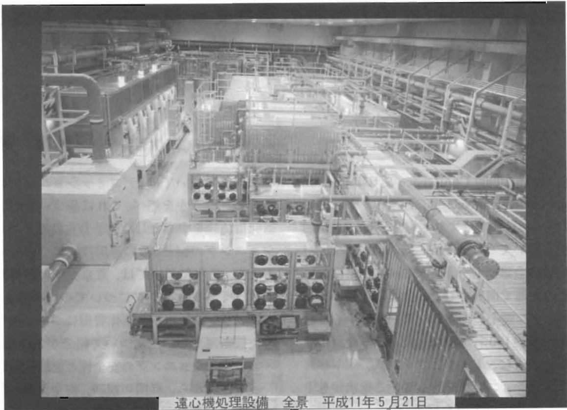
写真-1 遠心機処理設備 全景
